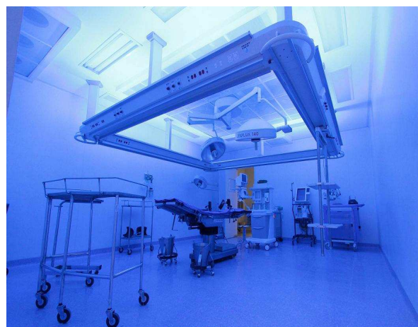
Fig. 08: quirófano con sistema de flujo laminar clase I
